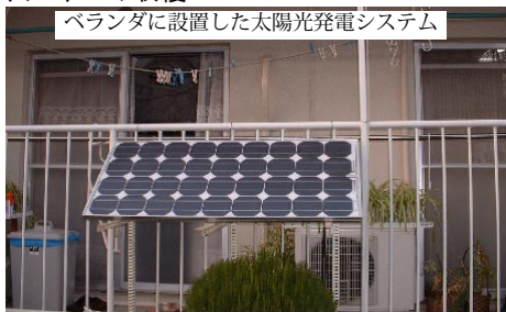
ベランダに設置した太陽光発電システム
